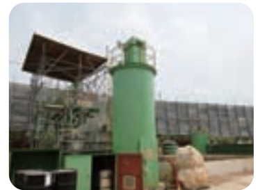
泥水処理装置
