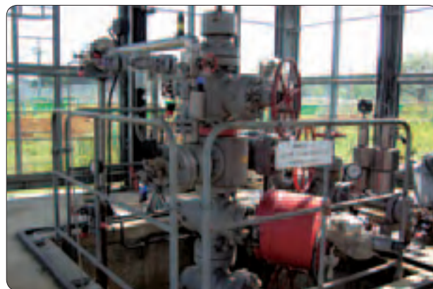
関原ガス 圧入排出井
