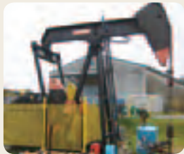
八橋油田ポンピングユニット
