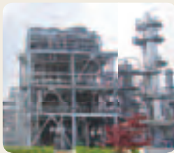
越路原プラントガス処理施設
