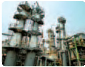
新潟県越路原プラントガス処理施設
