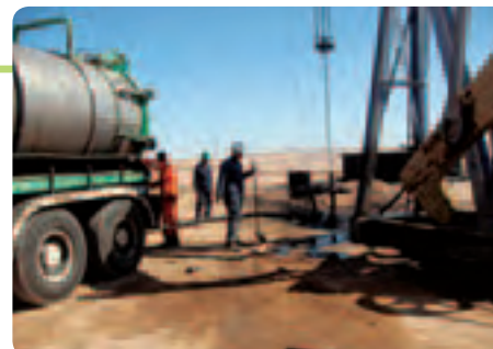
エジプトの油洩処理作業
