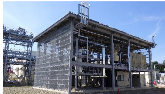
メタネーション試験設備
