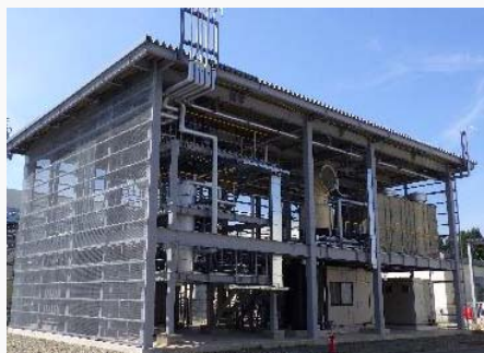
メタネーション試験設備
