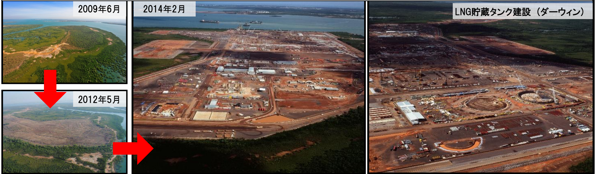
陸上ガス液化プラントサイト(ダーウィン)
