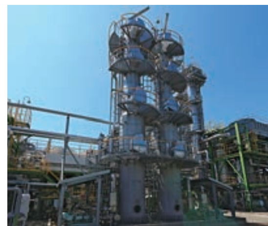
越路原プラント全景
