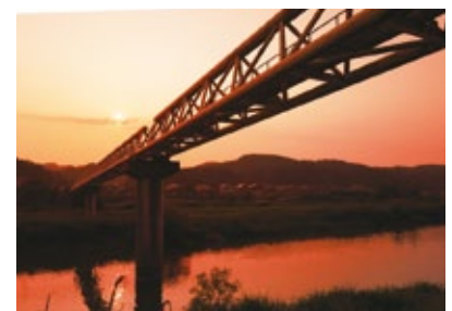
川を渡る天然ガスパイプライン(新潟県浪海川)
