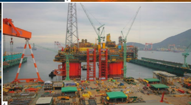
1: FPSO建造作業の様子 2: 生産井掘削作業“ENSCO5006” 3: 海底坑口装置設置作業の様子 4: CPF建造作業の様子
