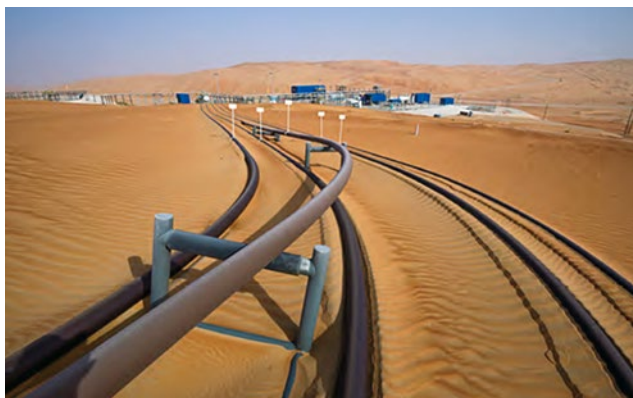
陸上パイプライン
