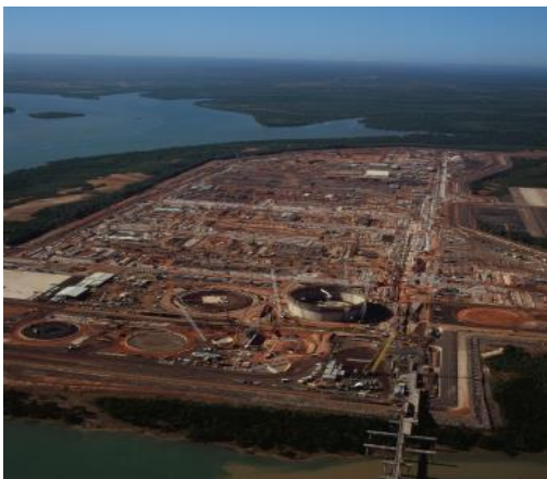
LNG Plant (Darwin, Australia)
