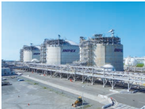
直江津LNG基地
