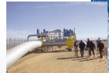
オハネットオイルアンドガス：ガス送出パイプライン
