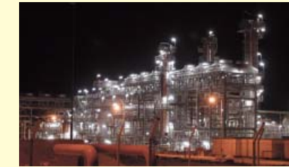
ガス処理プラント
