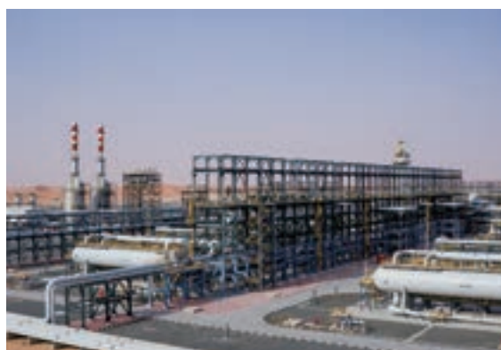
アブダビ陸上鉱区(原油処理施設)
