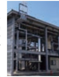
越路原プラント内の実証設備
