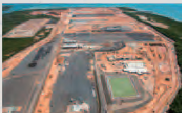
陸上ガス液化プラントサイト プラントサイトの航空写真。陸上ガス液化プラントのEPC（設計・調達・建設）作業は、日揮、千代田化工、米KBR社から構成される日米の共同企業体を実施しています。
